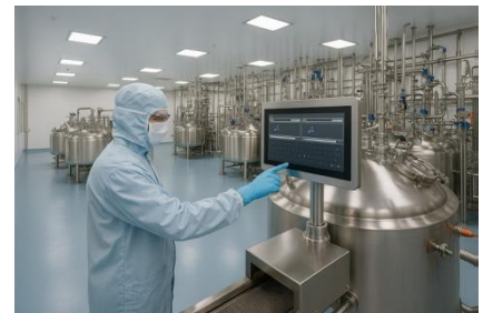
生物制药洁净车间
